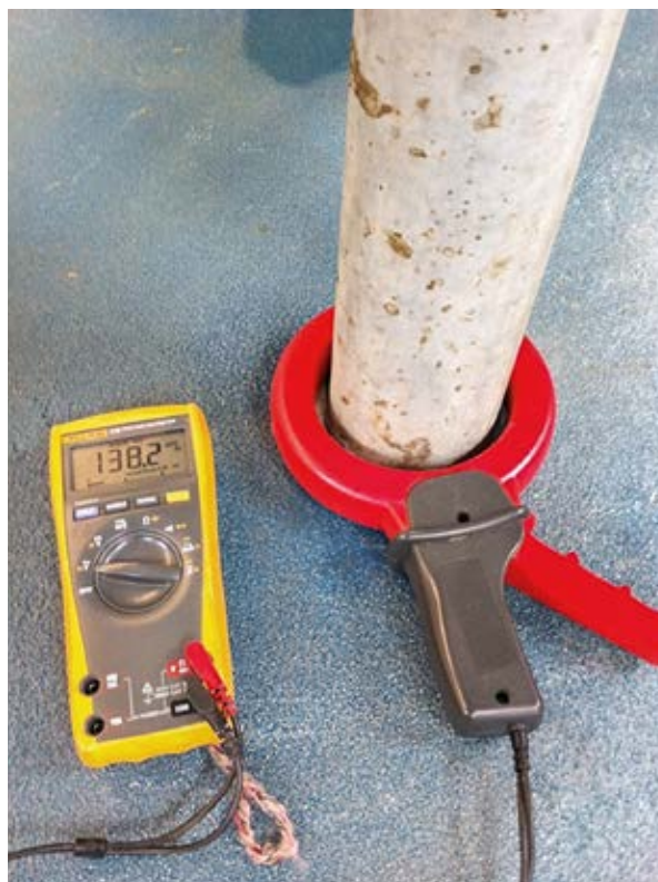
Mit geeigneten Messgeräten können vagabundierende Ströme beurteilt werden. Des appareils appropriés permettent d'évaluer les courants vagabonds. (Photo: T. Manser)
